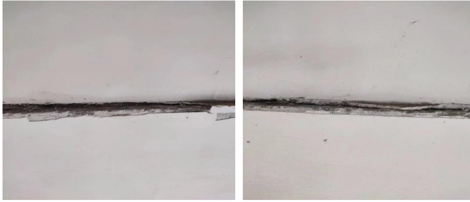
现场裂缝图片
