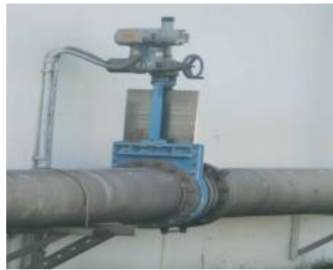
现场需维修的菱形刀闸阀
