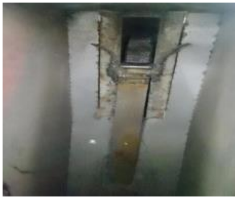
脱水机出泥口调节挡板
